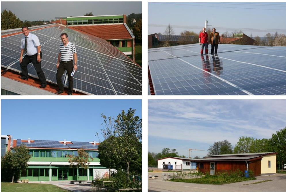
Abbildung 22: PV-Anlagen auf gemeindlichen Dächern
